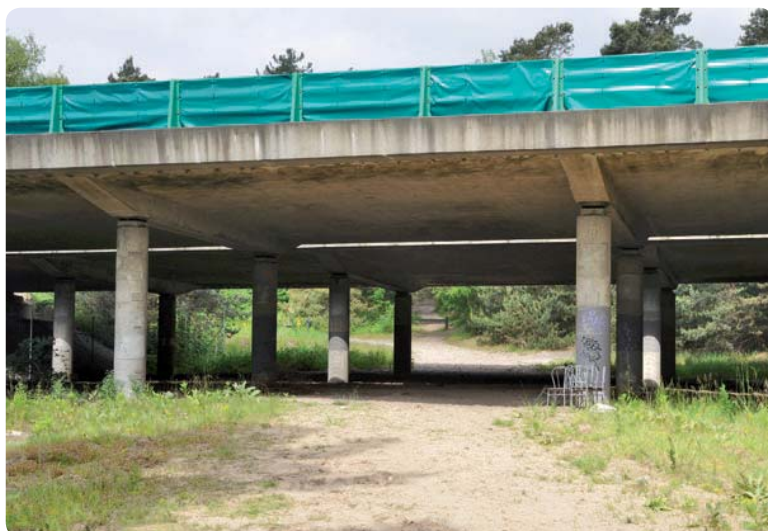
Ci-dessus, amélioration des conditions de circulation pour la faune sous l'autoroute A1
