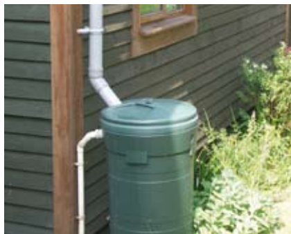
Collecteur d'eau de pluie sur gouttière
