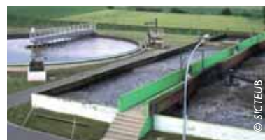
Bassin d'aération et clarificateur
