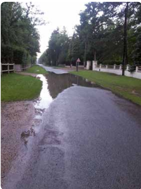
Stagnation des eaux pluviales dans le Lys-Chantilly.
