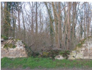
Un mur laissé en l'état après effondrement
