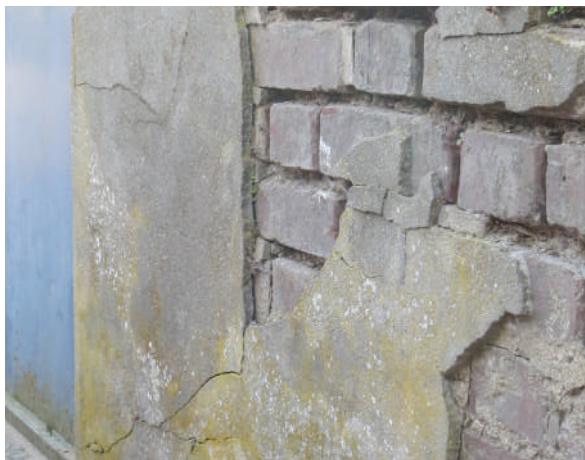
L'humidité s'accumule à l'arrière de l'enduit ciment appliqué sur un mur de brique ou de pierre. Les joints s'effritent et l'enduit se détache très rapidement
