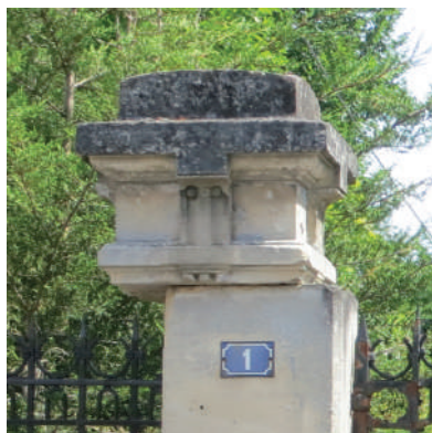
Recaler les pierres de chapiteau
