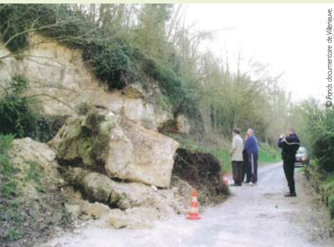
Aspect de zone éboulée en avril 2006.
